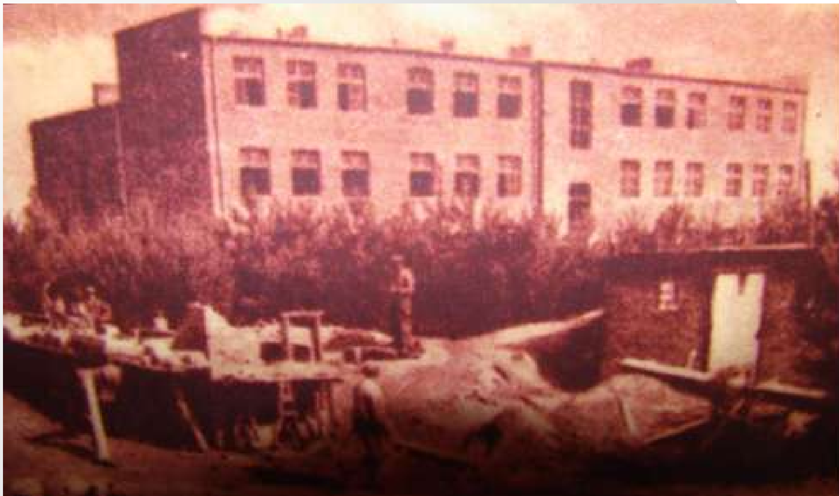
Rok 1937 – widok (od ul. Grunwaldzkiej) na budynek Szkoły Podstawowej w Chorzelach. Trwają prace przy jego wznoszeniu.
